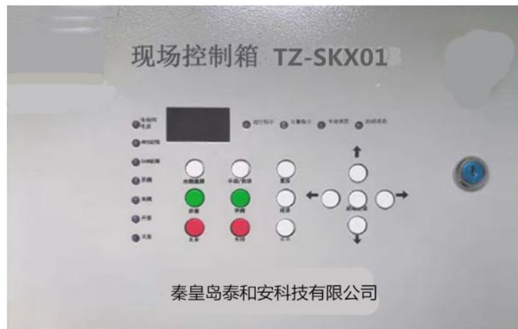
图 4-1 现场控制箱操作面板
